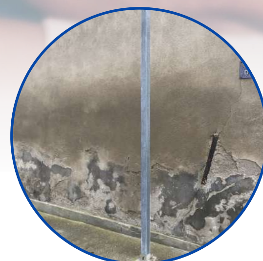
Linha de umidade
